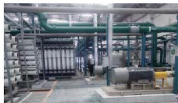
中煤集团中水回用、浓盐水处理、纳滤分盐系统运营服务
