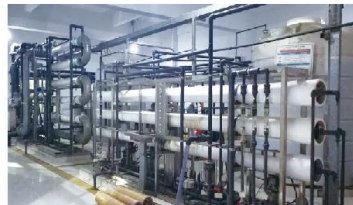
西安渗滤液应急处理系统
